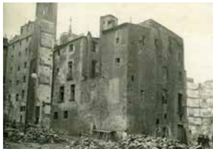
Enderroc d'una casa del segle XIV del carrer de les Donzelles, 1911. Frederic Balcells Maymí, AFB.
